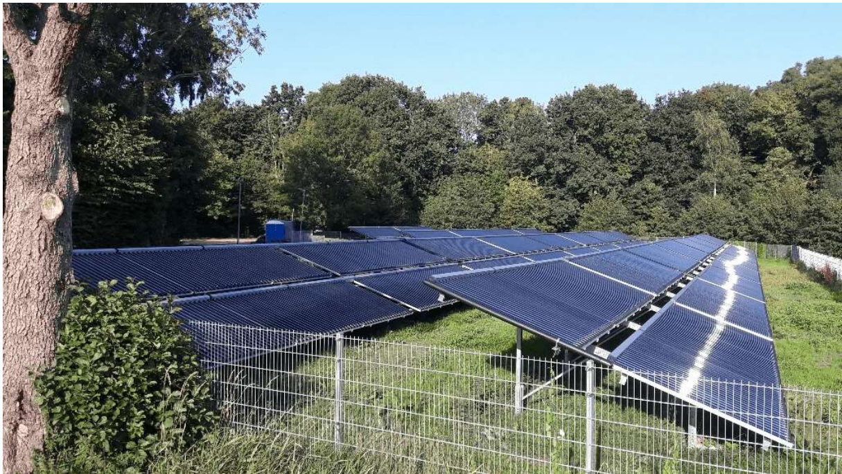
Solarthermieanlage der Bürger GemeindeWerke Breklum eG
